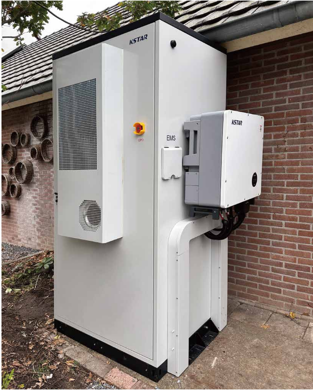
03 C&I ESS Projekt in den Niederlanden
